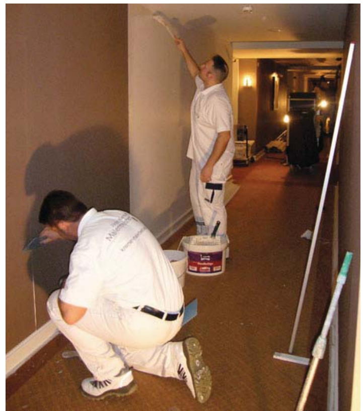
Jürgen Kremer und sein Team verkleben bei der Renovierung der Gästeflure mit Metylan Ovalit T 3,2 km 2 Vinylwandbekleidung.
